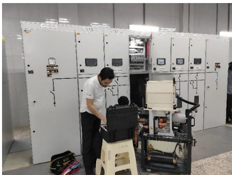
شکل ۹- دستگاه در حال تست رله های Secheron در پست ترکشن خط ۲ قطار شهری مشهد
